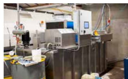
Die Zentralanlage zur Filtrierung des Kühlschmierstoffs.
