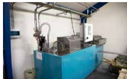
Die Zentralanlage zur Filtrierung des Kühlschmierstoffs.
